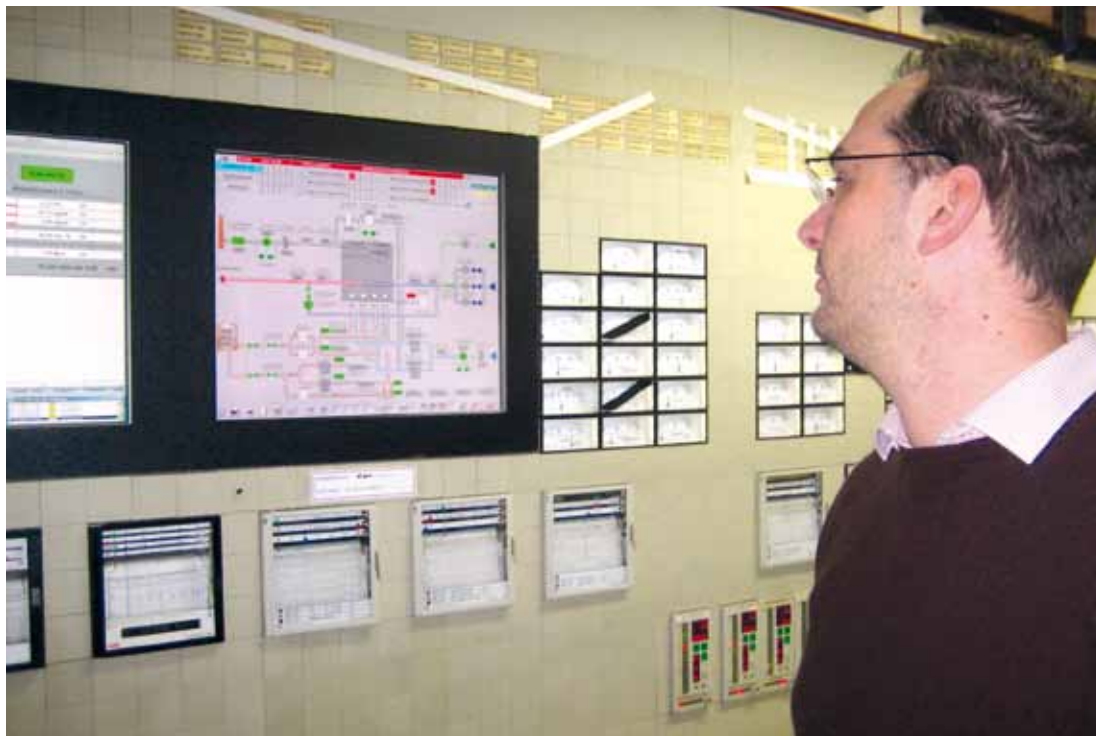
Software-Inbetriebnahme Software commissioning
