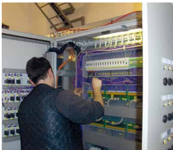
Umverdrahtungen und Inbetriebnahme der Neuanlage Rewiring and commissioning of the new plant
