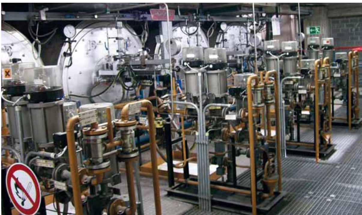
Kessel- und Brenneranlage
