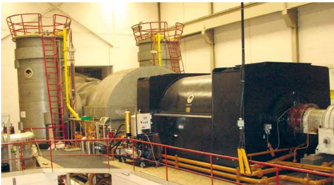
Gasturbine mit Generator
