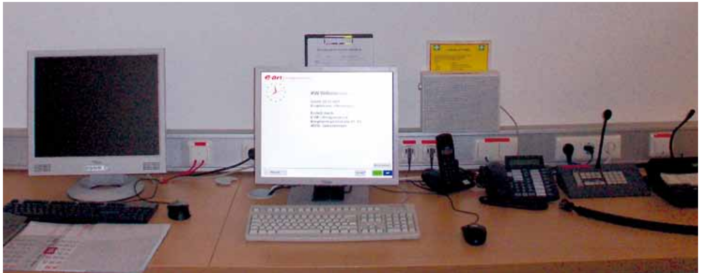
Zentraler Engineering- und Bedienplatz für die Klimaanlagesteuerung in der Warte Central engineering and operator workstation for air-conditioning system in control room
