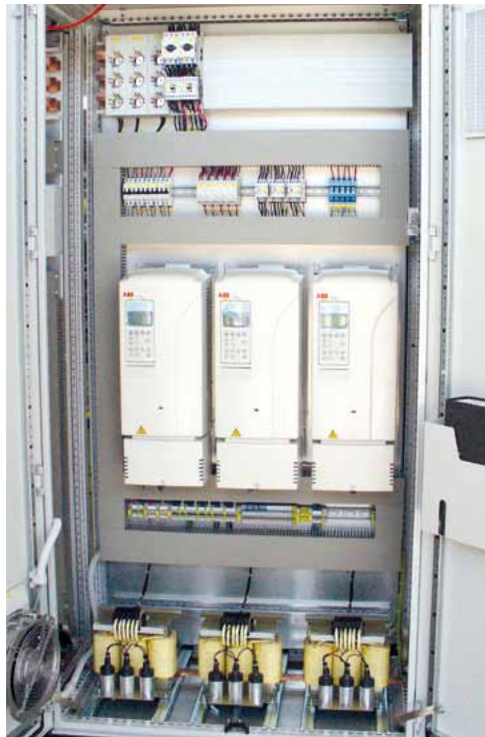
Frequenzrichterschrank Frequency converter cabinet
