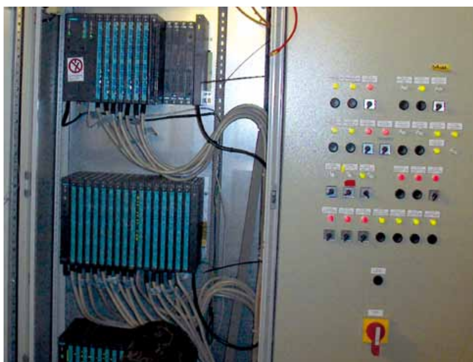
Neue Zentralsteuerung Simatic S7-400 New Simatic S7-400 central control system
