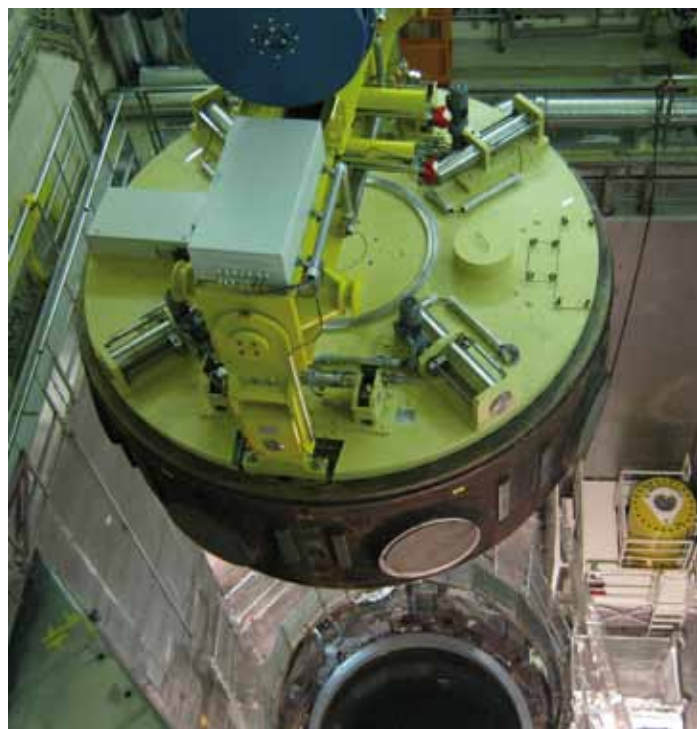
Fernbedienter Transport - Oberteil mit Traverse und Abschirmplatte Remote-controlled transfer of top part with lifting beam and shielding plate
